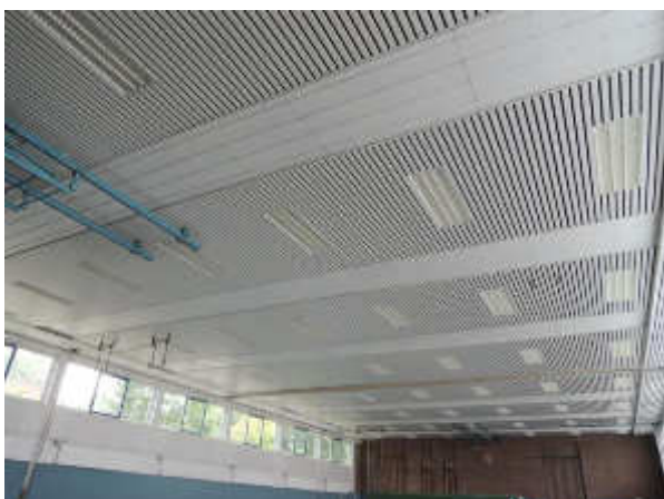
Abbildung 5: Beleuchtung alte Turnhalle
