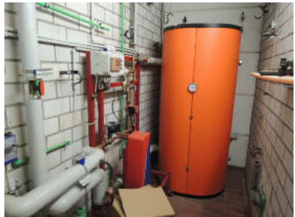
Abbildung 4: TWW-Speicher neue Turnhalle
