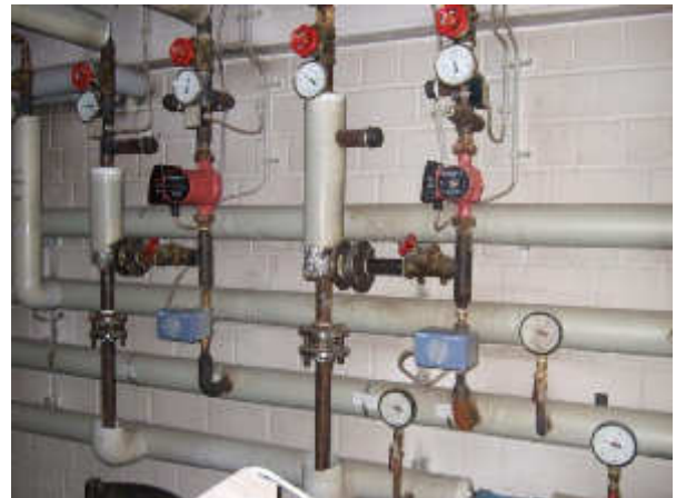
Abbildung 2: Heizungsverteilung, schlecht isoliert
