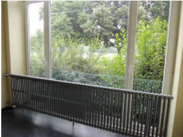
Abbildung 1: Heizkörper vor Fenster
