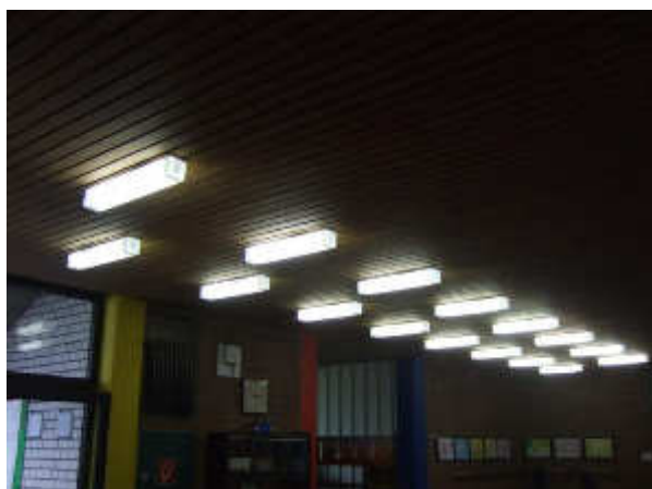
Abbildung 5: Beleuchtung Flur (EG)
