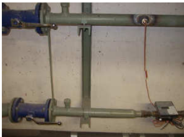
Abbildung 3: Fernwärmeübergabe, ungedämmte Leitungen
