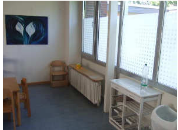
Abbildung 2: Fensterelemente mit Heizkörpern
