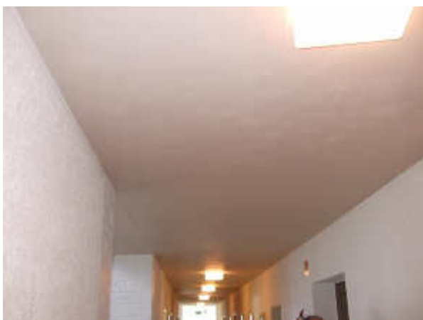
Abbildung 5: Beleuchtung Flur (EG)
